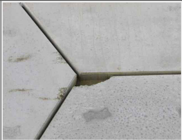
콘크리트 패널 파손
