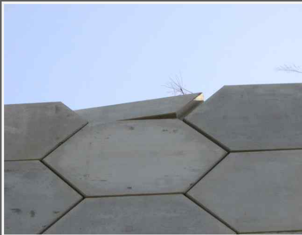
콘크리트 패널 설치불량
